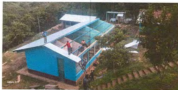
Foto 4: Instalaciones de laminas módulo I
